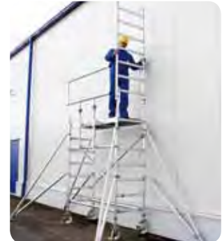
Gesichert durch das „vorlaufende“ Geländer kann die Plattform nun gefahrlos betreten und der weitere Gerüstaufbau fortgesetzt werden. Das Montagesicherungsgeländer wird für folgende Plattformen wieder „vorlaufend“ eingesteckt ehe die nächste Ebene betreten wird.
